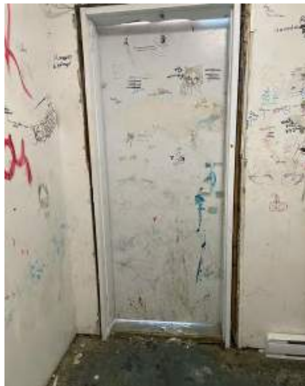
Porte non étanche d'un bloc appartement à Manawan
