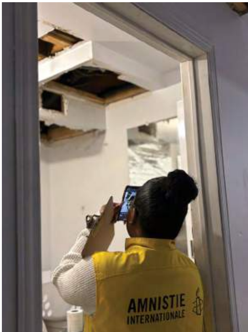
Trous dans un plafond d'une maison à Manawan
